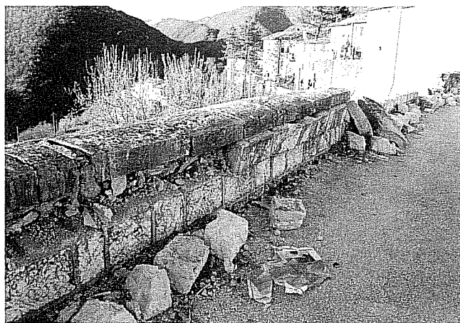
Foto 19. Sellano centro storico. Parapetto basso di un muro di contenimento fortemente danneggiato per la particolare violenza delle scosse.
